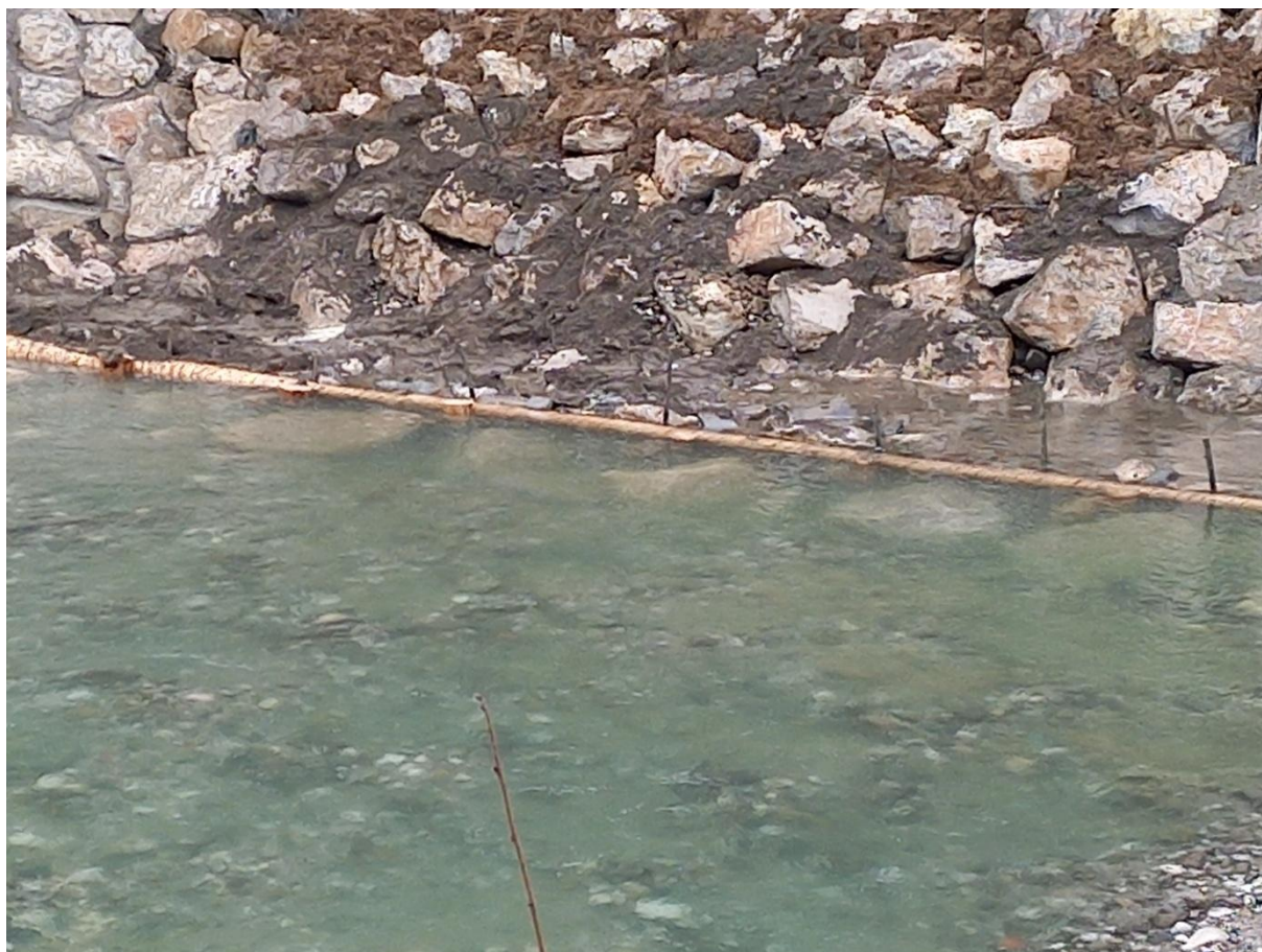
Slika 12: Zavarovanje brežine izvedeno s piloti in kamnometom s potopljenimi večjimi skalami. Vodotok: Savinja. Foto: arhiv, ZZRS.
