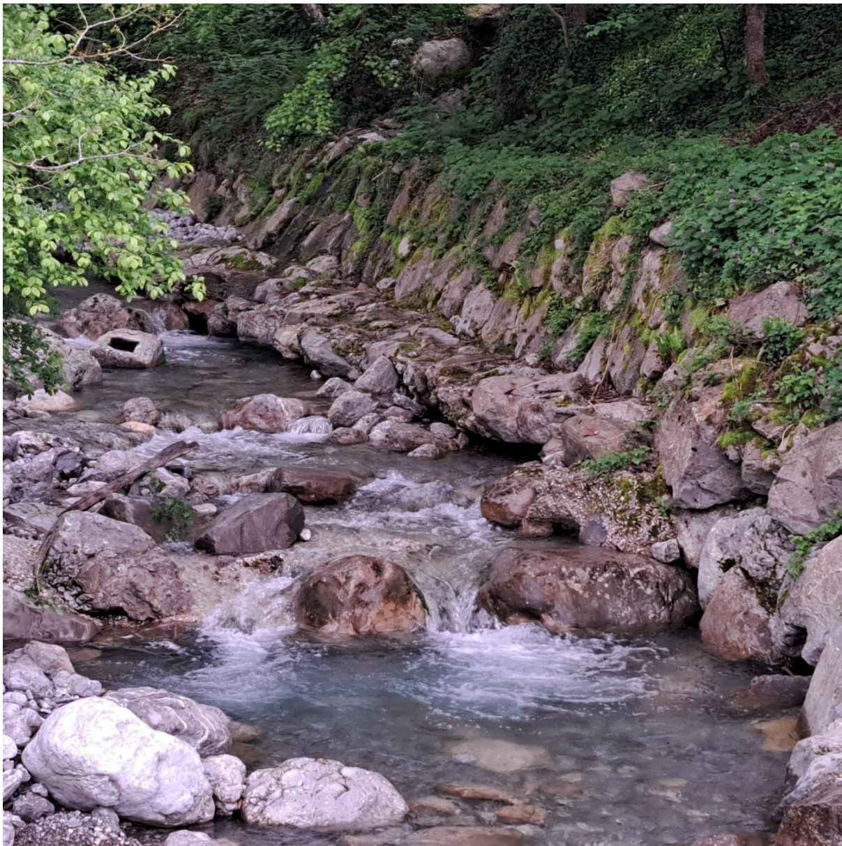
Slika 21: Spodjedena peta utrditve brežine služi kot skrivališče za ribe. Vodotok: Godiča. Foto: arhiv, ZZRS.
