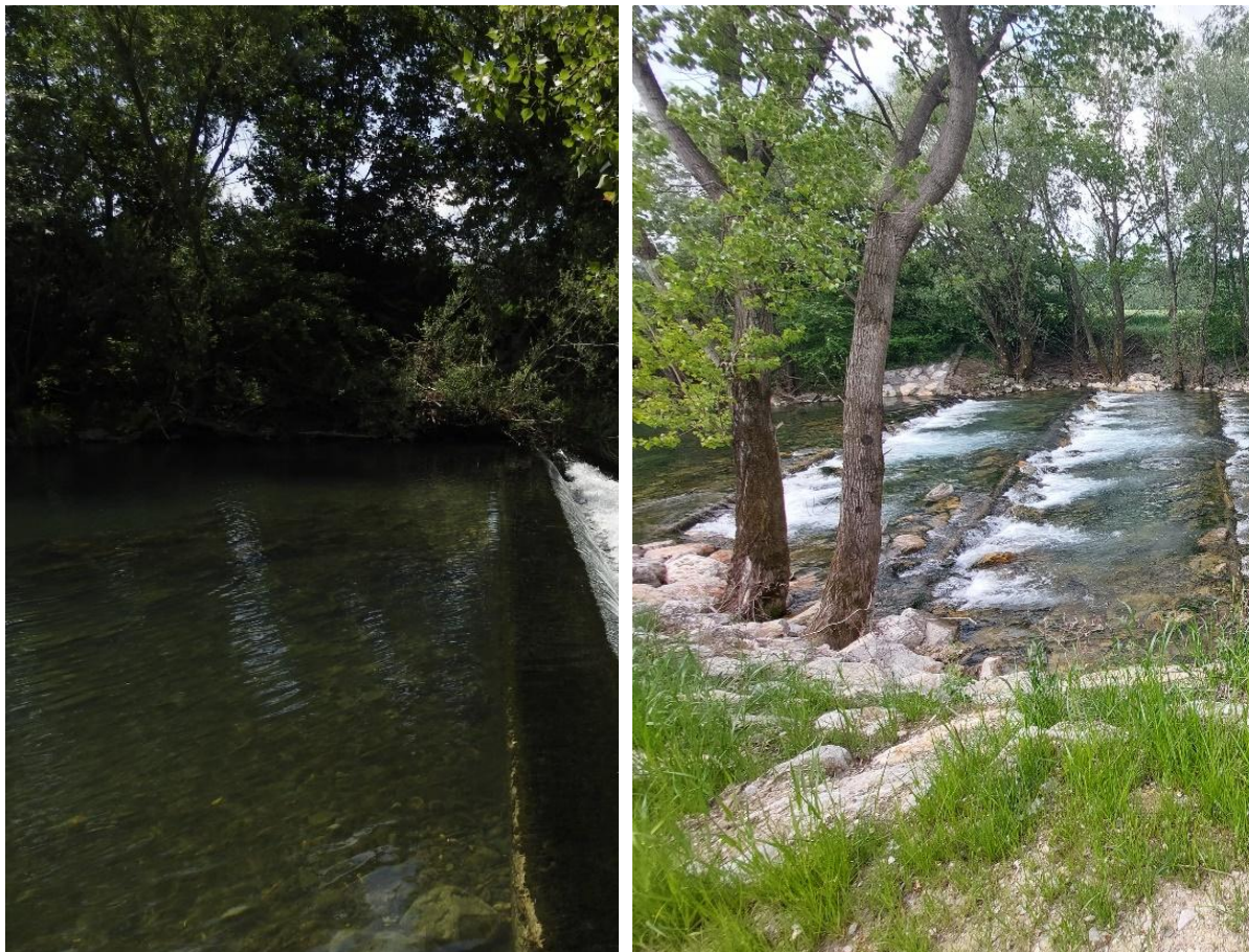
Slika 24: Preoblikovanje neprehodne pregrade v serijo pragov (fotografiji prej in potem). Vodotok: Vipava. Foto: arhiv, ZZRS.
