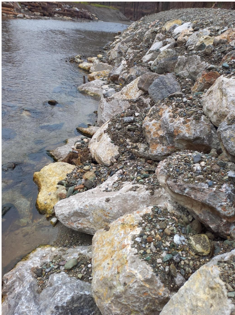
Slika 11: Nепорavnano izvedena zložba v suho. Vodotok: Dreta. Foto: arhiv, ZZRS.
