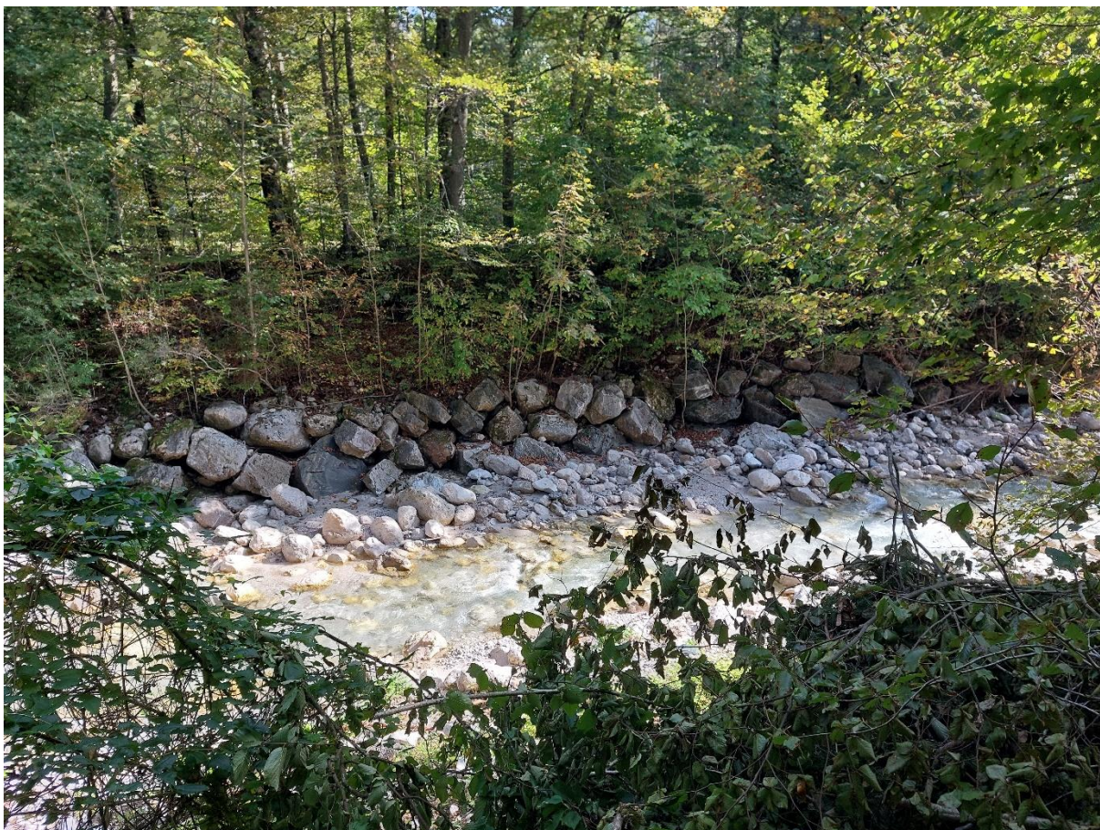
Slika 4: Neporavnano zavarovanje brežine. Vodotok: potok Ljubeljska Borovnica (Loiblbach), Borovlje, Avstrija. Foto: Arhiv ZZRS.
