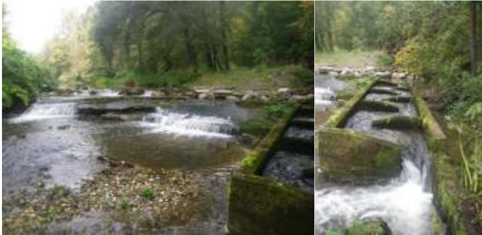
Slika 77: Pregrada na izlivnem delu Gameljščice, pri ribiškem domu (levo) in ribja steza (desno).
