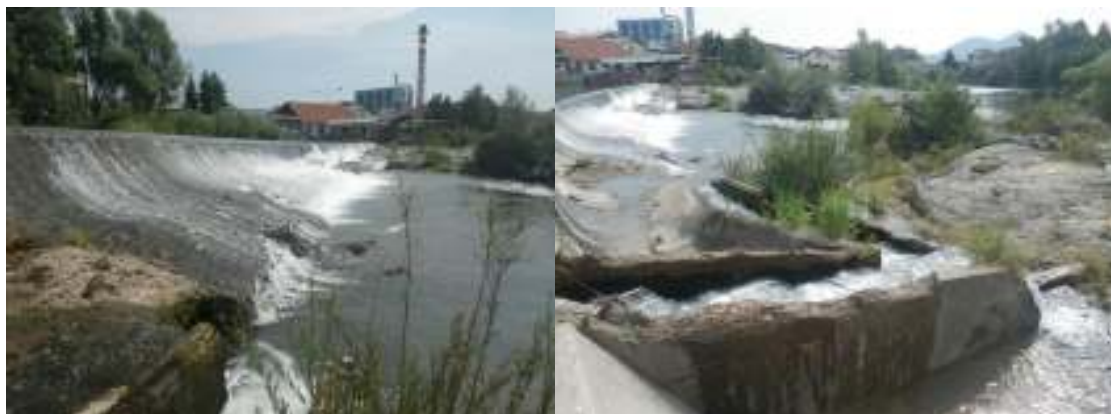
Slika 74: Jezovna zgradba jez v Goričanah (levo) in prehod za ribe na jezovni zgradbi.
