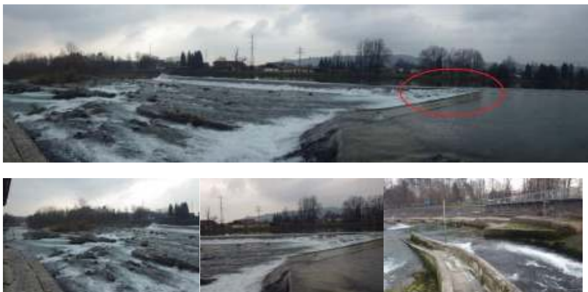
Slika 54: Jez v Tacnu. Hrapava drča v špici jezusa (zgoraj, označeno z rdečo), strme skalnate stopnje pod jezom (spodaj levo), hrapava drča – prehod za ribe v špici jezusa (spodaj sredina) in opuščeni prehod za ribe tehničnega tipa (spodaj desno).
